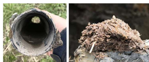
図4 既設暗渠の経年変化状況
